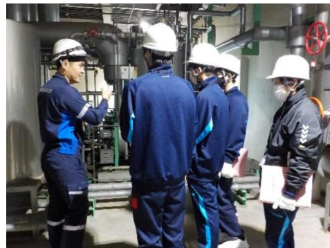
メタン発酵施設の点検業務
