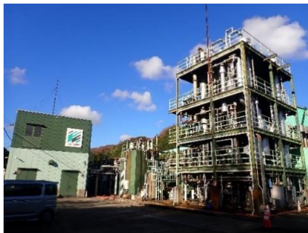
富士クリーン 浸出水処理施設
