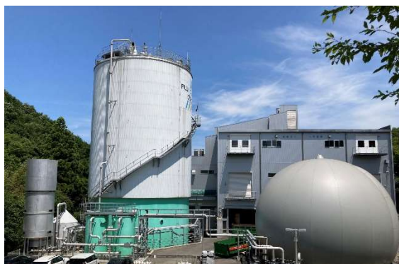
乾式メタン発酵施設
