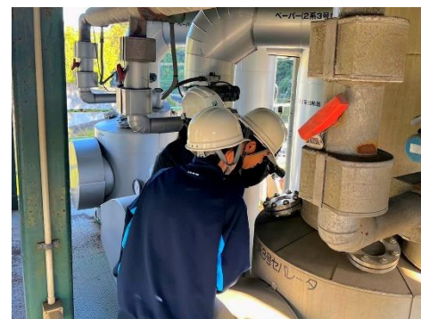
（浸出水処理の現場機器点検）
